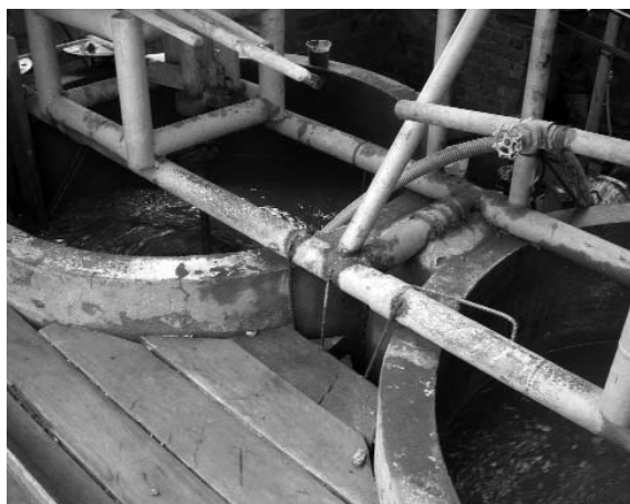
Foto 30: Planta de cianurización.
